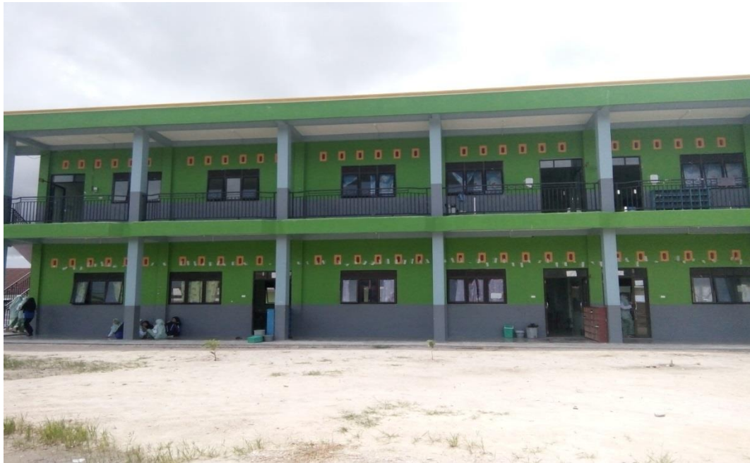
Dokumentasi kondisi gedung kelas saat jam pelajaran berlangsung (kelas putri)
